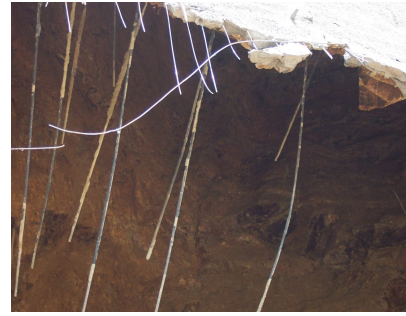
图 2 坍塌掉下的钢筋网
