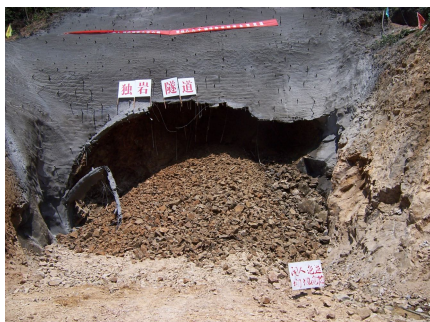
图 1 桥头端洞口坍塌
